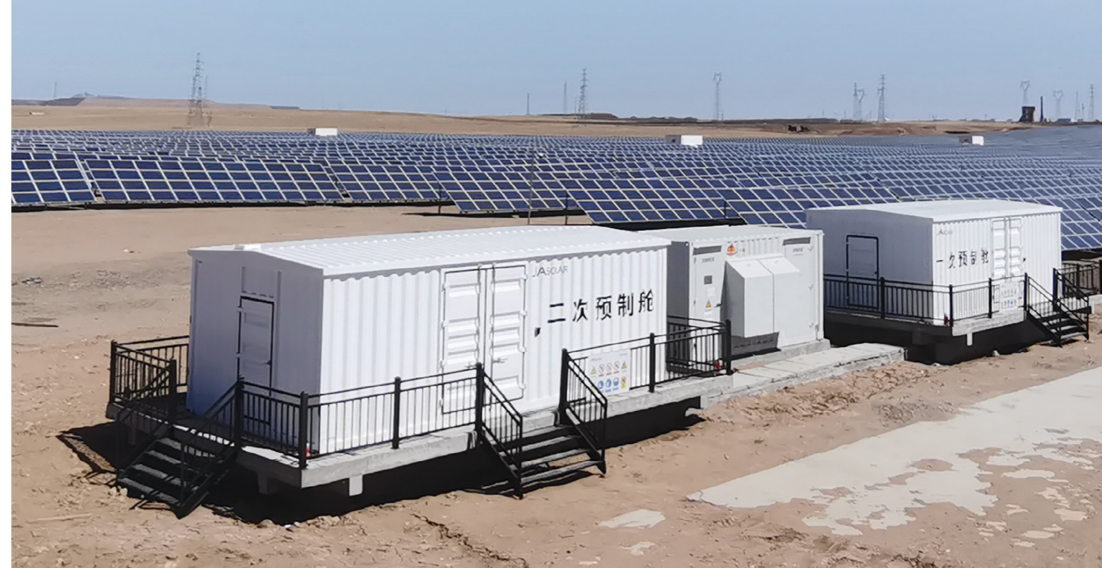
包头农光伏发电项目 Baotou Agrivoltaic Power Project (Phase I 10 MW)
