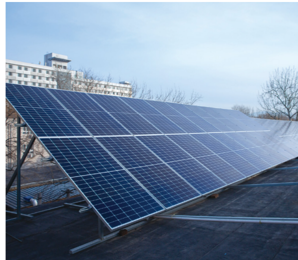
清华大学“光储充备一体化”科研项目光伏部分 Tsinghua University's PV research project
