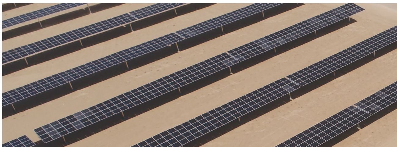
乌兹别克斯坦纳沃伊光伏项目 Uzbekistan Navoiy PV power plant Project
